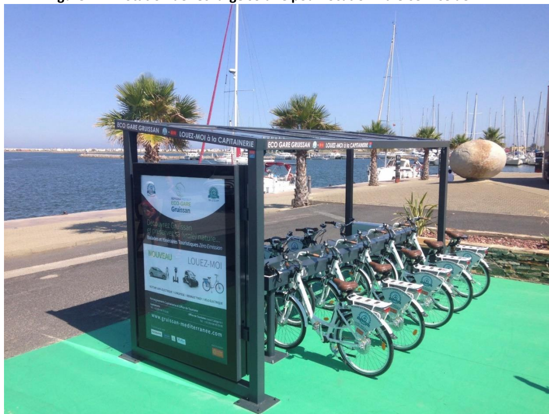
Figure 4.11 : Station de recharge solaire pour location libre-service de VAE 119
